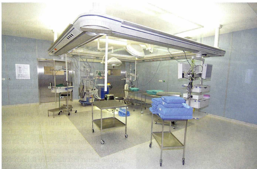
Einzelne OP-Einheit im Großraum-OP. Die kastenförmige Medienversorgungseinheit an der Decke bietet, neben Hygienetechnik und Lichtsteuerung, auch einen sicherheitsverglasten Schutzvorhang rund um das Operationsfeld.
